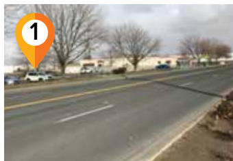
1 Rehabilitación del pavimento asfáltico de la calle Rose Street Sellado de grietas, sellado con la técnica chip and fog, repintar las demarcaciones de tráfico y mejoras a las señales de tráfico; de College Place a la calle Isaacs Avenue
