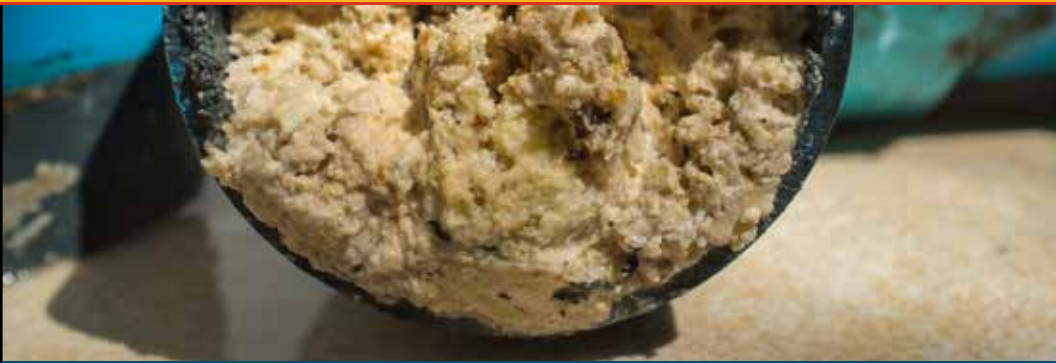
Esta es una tubería de drenaje con una gran obstrucción de grasa. No sólo es asqueroso, reduce el diámetro de su tubería y puede crear bloqueos.
